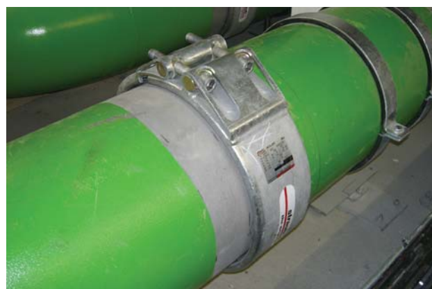
Система охлаждения двигателя, рабочее давление 6 бар, температура до 60°C
